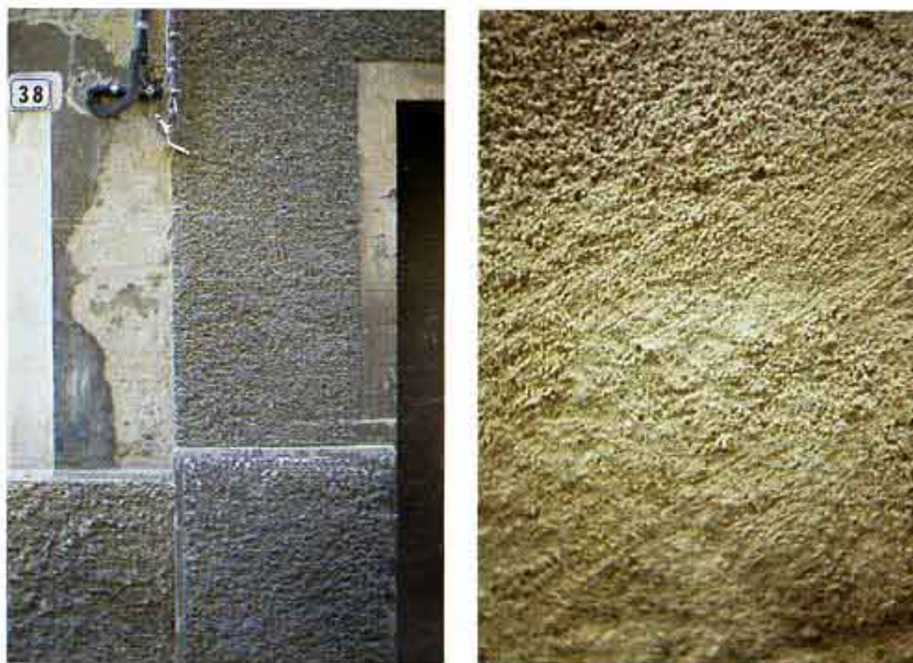
Fig. 32 - Via Lea, edificio civile. 5 - Intonaco a base di calce interessato da fenomeni di degrado determinati dai processi di decoesione dei materiali che lo compongono. 6 - Particolare della superficie interessata dai processi di decoesione.
