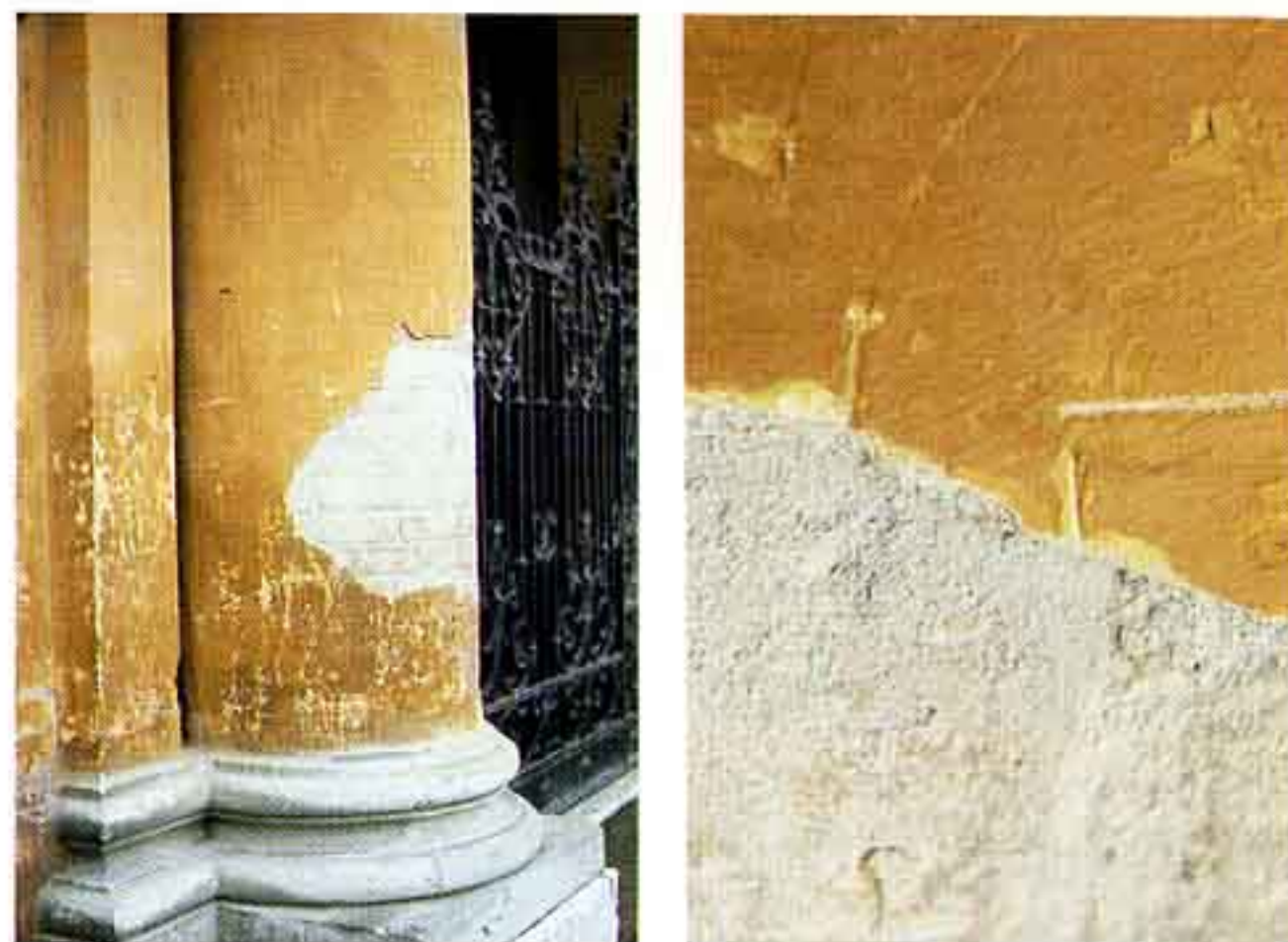
Fig. 31 - Piazza della Rosa, Palazzo Ducale estense. 3 - I fenomeni di degrado, che determinano il distacco dell'intonaco dal paramento murario, hanno completato la loro opera disgregatrice. 4 - Nel particolare è rappresentato il paramento murario che è rimasto parzialmente scoperto.
