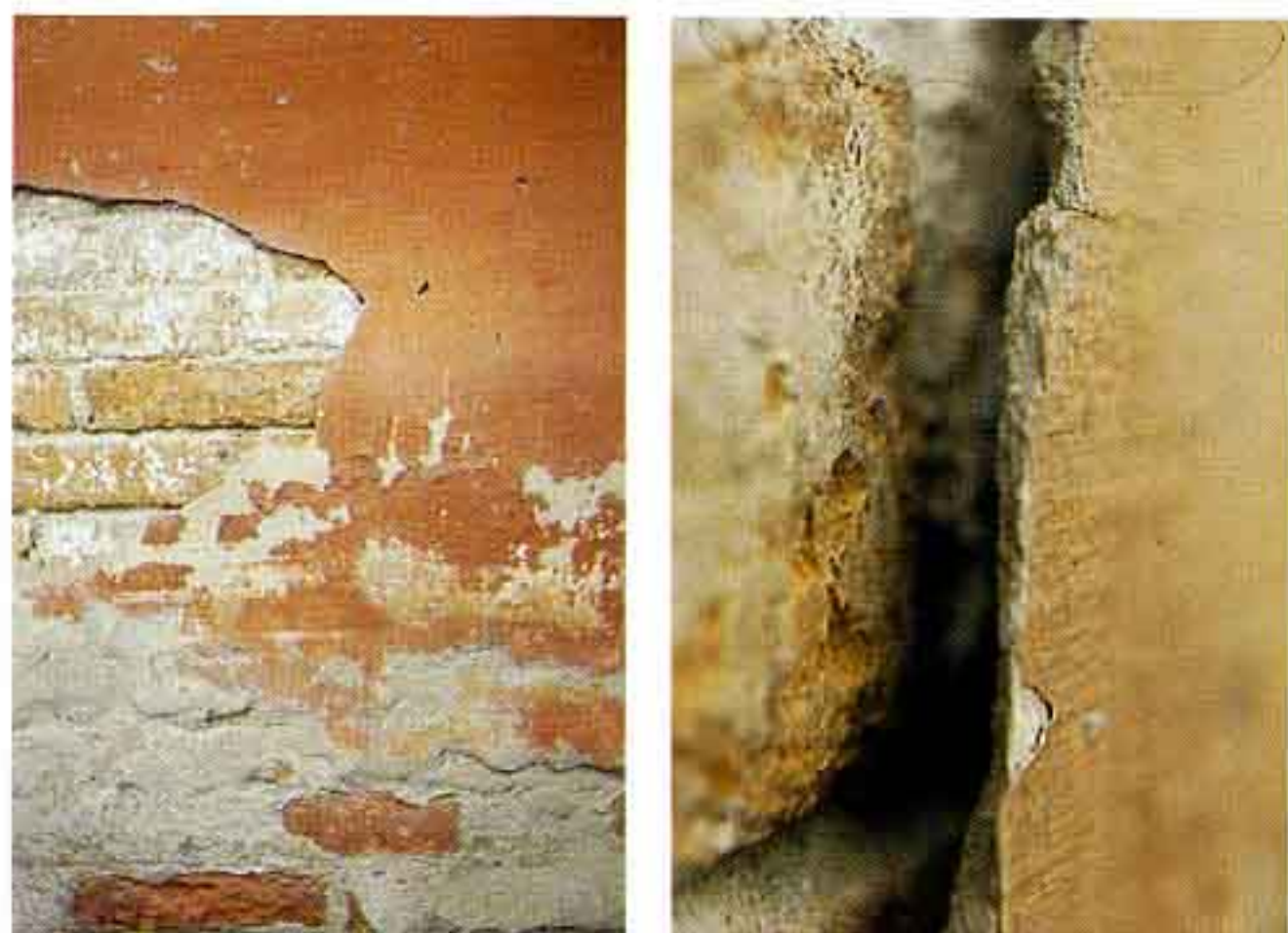
Fig. 30 - Piazza della Rosa, Palazzo Ducale estense. 1 - Fenomeni di degrado che interessano gli intonaci a base di calce messi in opera sulla facciata principale del palazzo. 2 - Nel particolare è rappresentato l'inizio del fenomeno di distacco dell'intonaco dal paramento murario.
