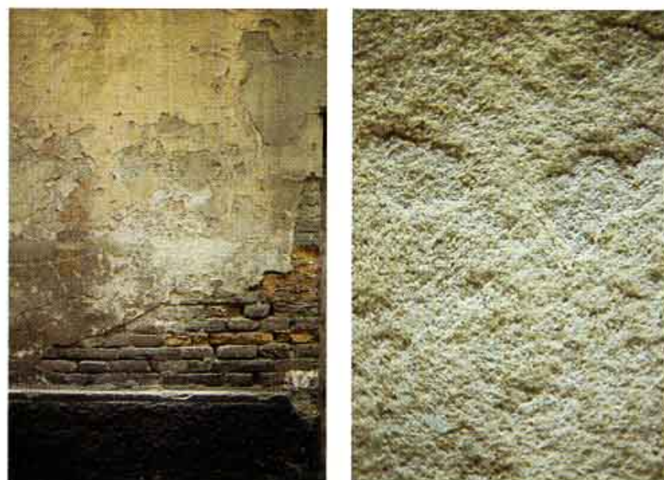
Fig. 33 - Via Cavedoni, edificio civile. 7 - Intonaco a base di calce sottoposto a fenomeni di disgregazione causati da agenti di degrado esterni (acque meteoriche, vento, gelo, ecc.). 8 - Particolare di una porzione di superficie dell'intonaco sottoposta all'azione di degrado causata dagli agenti atmosferici.
